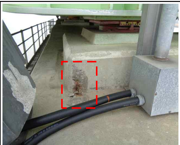
인천방향 MP23-SH1 받침콘크리트 파손
