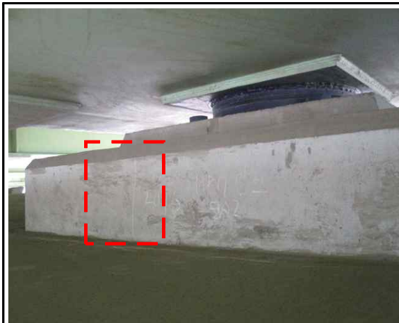
인천방향 MP7-SH2 받침콘크리트 균열
