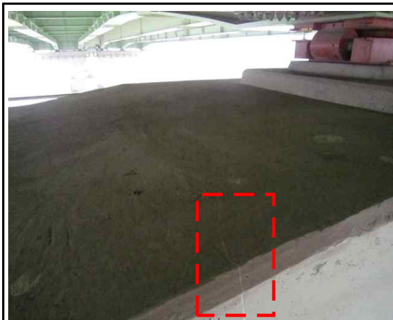
일산방향 MP13 코핑부 폭 0.3mm미만 균열
