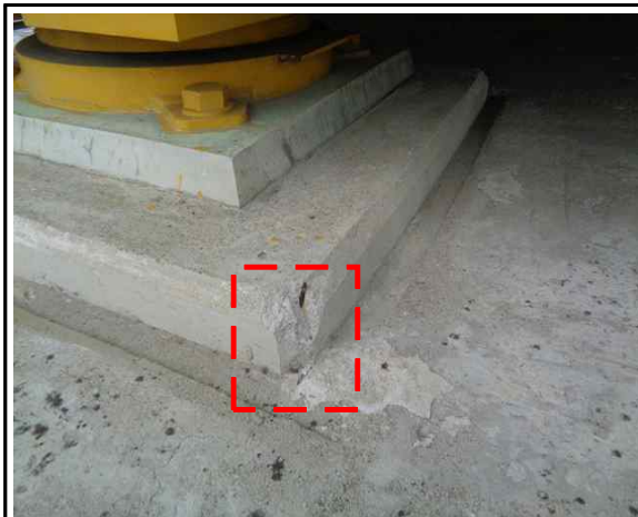
일산방향 MP10-SH1 받침콘크리트 파손
