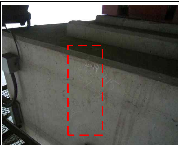
인천방향 MP15 코핑부 폭 0.3mm미만 균열
