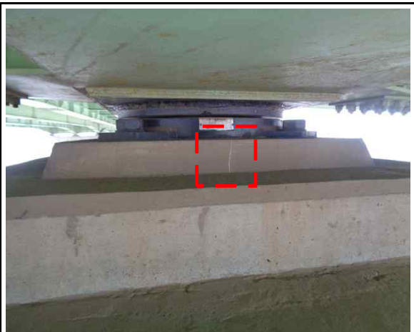
일산방향 MP25-SH2 받침콘크리트 균열
