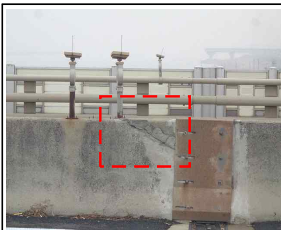
인천방향 S27 중분대 파손
